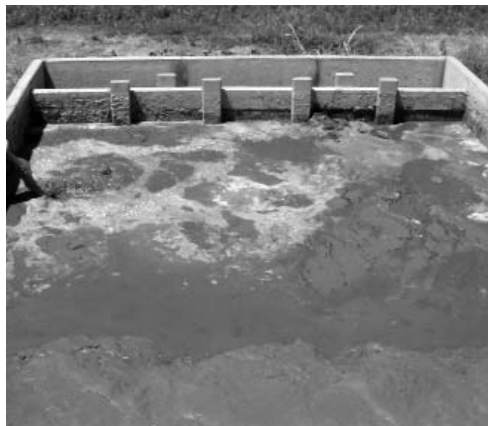
● Foto 6. Decantador de sólidos.
